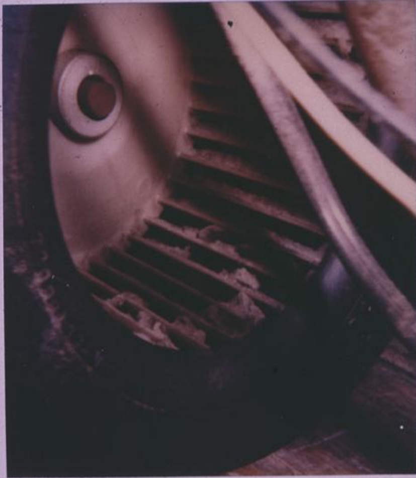
FAN INSIDE UNIT - DIRTY
